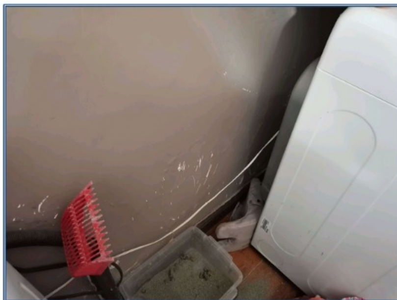
Ilustración #4. Problemas de humedad en pared de cuarto de pilas
